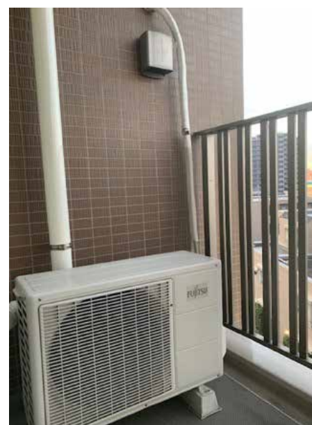
■図1 参考写真 室外機と手すりが近接している例
