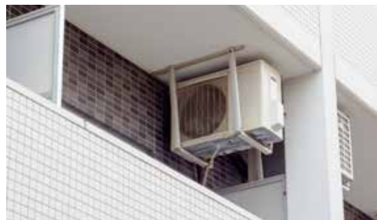
■図3 参考写真 天吊り型室外機置場
